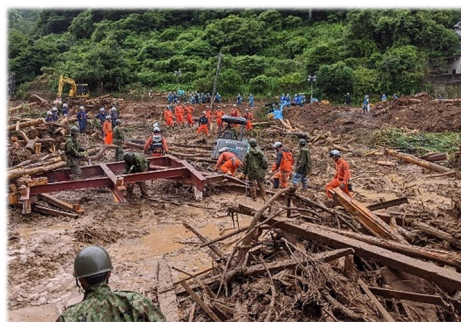
災害時における活動状況
