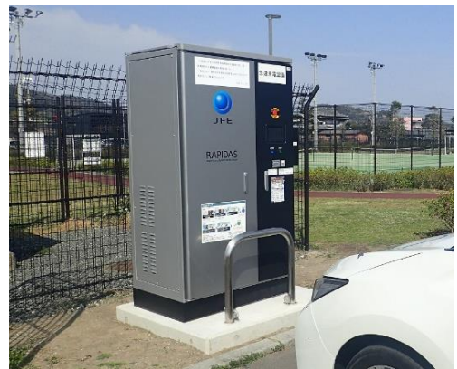
城山公園の EV 急速充電器（出所：熊本市 HP 26 ）
