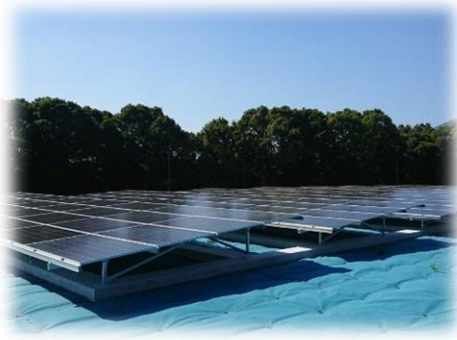
万日山配水池の太陽光発電設備
