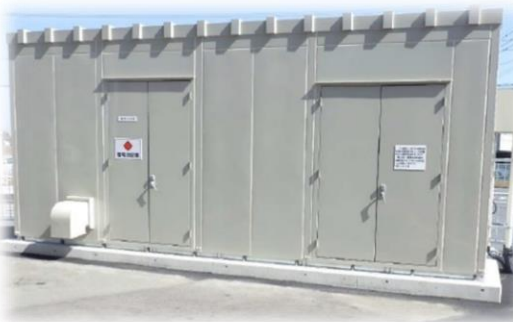
南区役所の大型蓄電池
