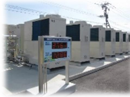
東部浄化センターの消化ガス発電設備
