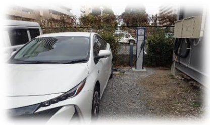
普通充電設備
