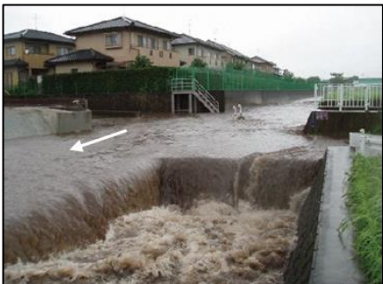
▲健軍川の溢水状況 (未改修区間-長嶺南8丁目)
