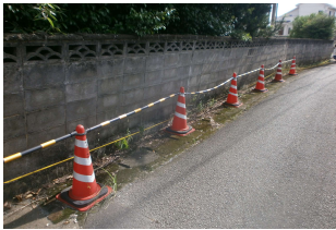
道路側への傾きが5度以上
