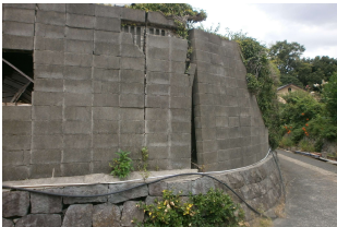
ブロック部分の高さが2.2m超
