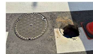
陥没した道路の様子
