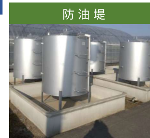
※タンクの周りに設ける囲い。タンク転倒時に重油の流出を防止する。
