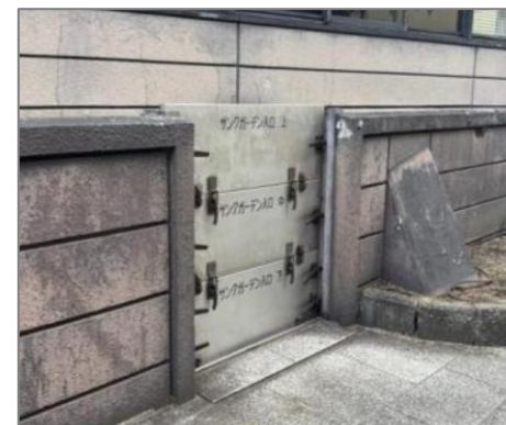
止水板施工例 (事業所等地下進入口等)
