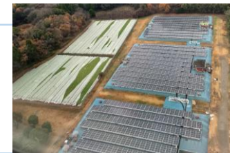
【高遊原配水池に設置した太陽光】
