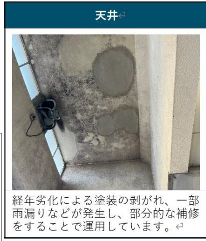
給食施設の劣化状況例
