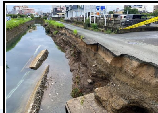
健軍川護岸崩壊 (東区神水本町)
