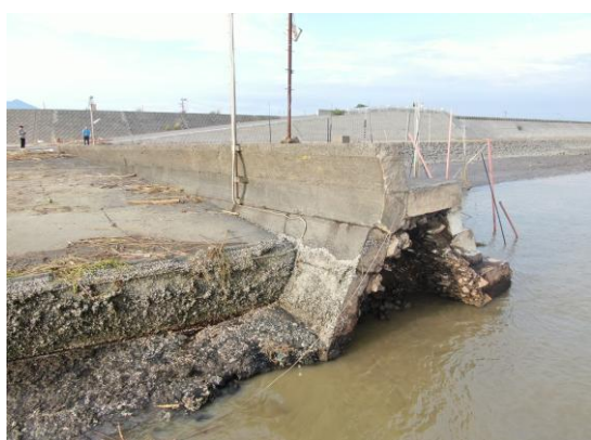
防波堤の欠損
