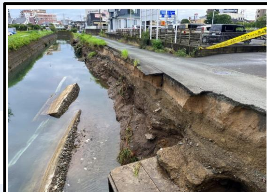
健軍川護岸崩壊 (東区神水本町)
