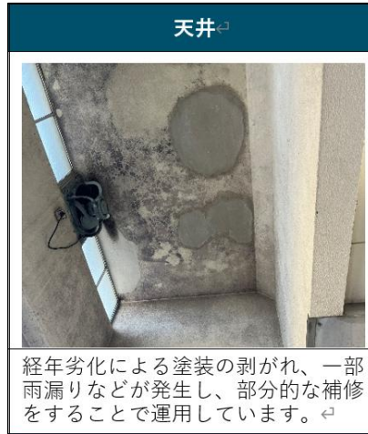
給食施設の劣化状況例
